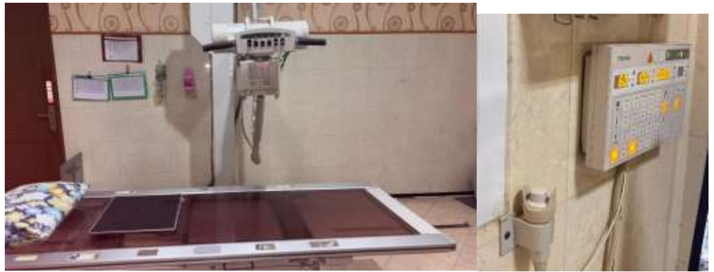
Gambar 3. Pesawat Sinar-X & Panel Control (Instalasi Radiologi RSU Islam Klaten, 2025)
